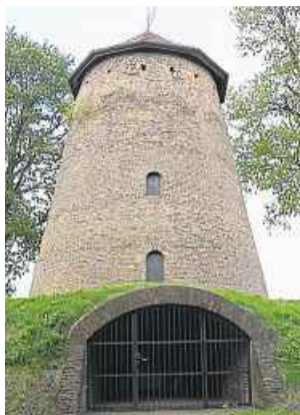
Das Ehrenmal muss saniert werden. Foto: sp
