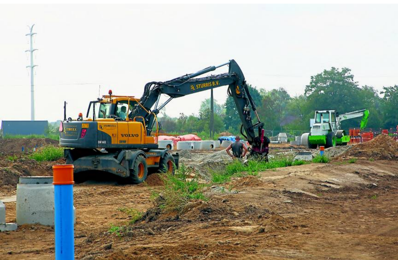
Im Anholter Osten rollen die Bagger und verlegen Kanäle. Wenn die Arbeiten weiterhin im Zeitplan liegen, können etwa ab Dezember die Häuser gebaut werden.
